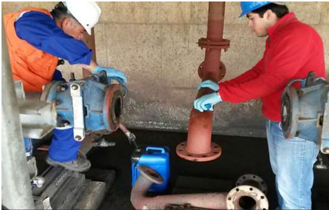
Figura 4. Extracción de lodo sanitario mixto desde la cámara de mezcla de la PTAS, ESSBIO S.A., Concepción.
