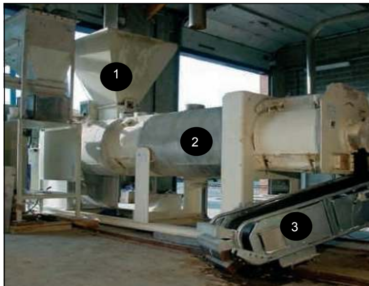
Figura 10. Sistema de tratamiento con cal: (1) Silo y dosificador de cal, (2) Mezclador cal-lodos y (3) Cinta transportadora (European Lime Association, 2004).
